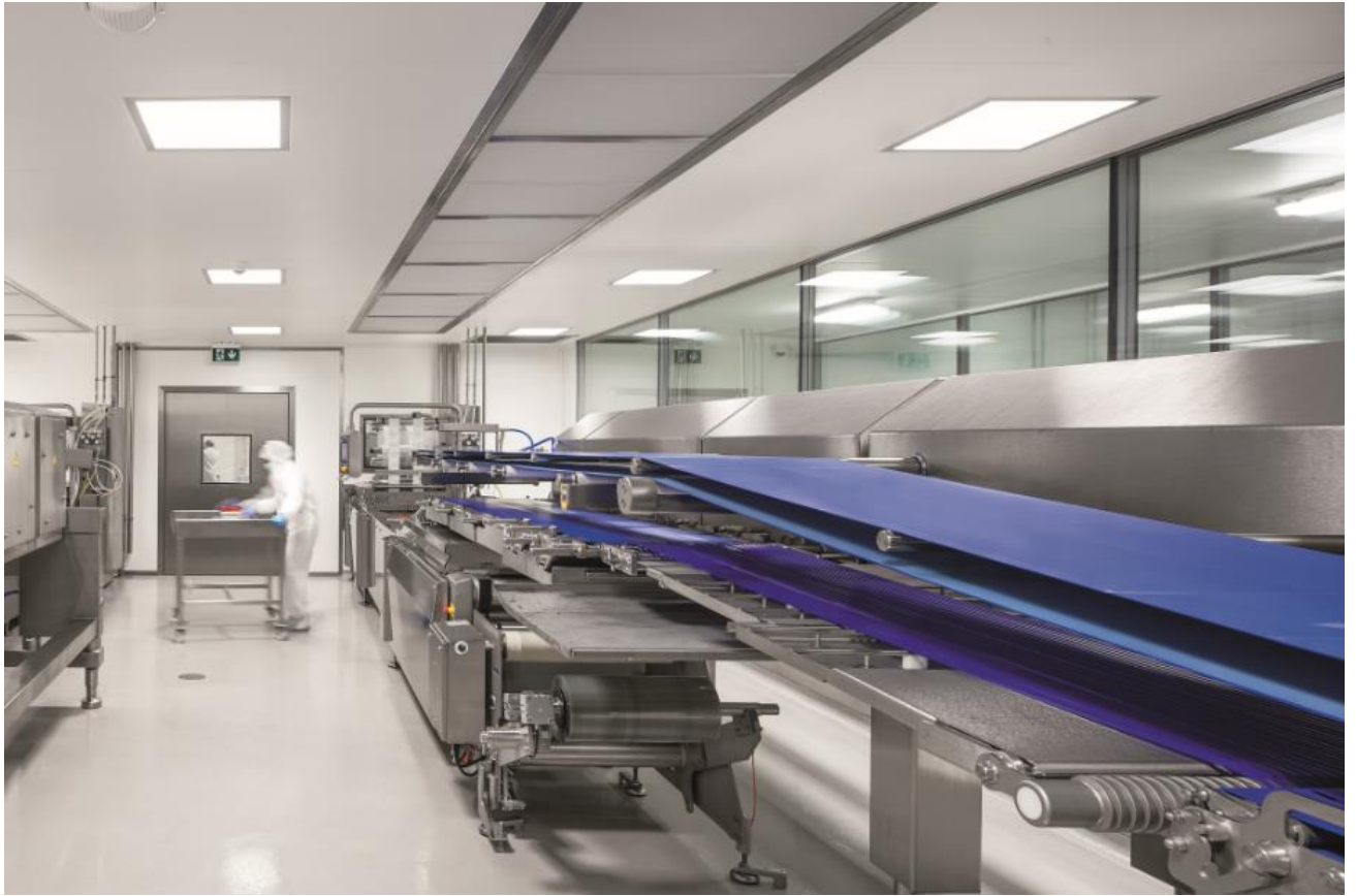
Abbildung 5: Zumtobel CLEAN-Leuchten wurden in den Reinräumen montiert, um die erforderliche ISO-Klasse zu erreichen.
