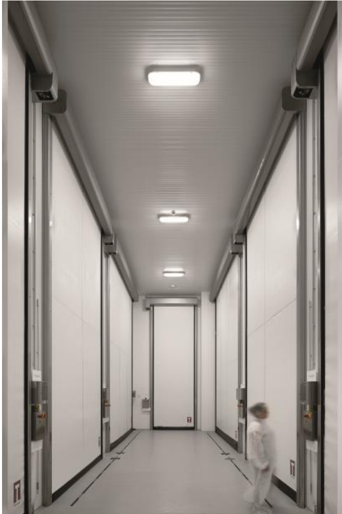
Abbildung 2: Dank neuester LED-Technologie stellt die Thorn ForceLED im Lagerbereich eine hervorragende Energieeffizienz und größere Wartungsintervalle sicher.
